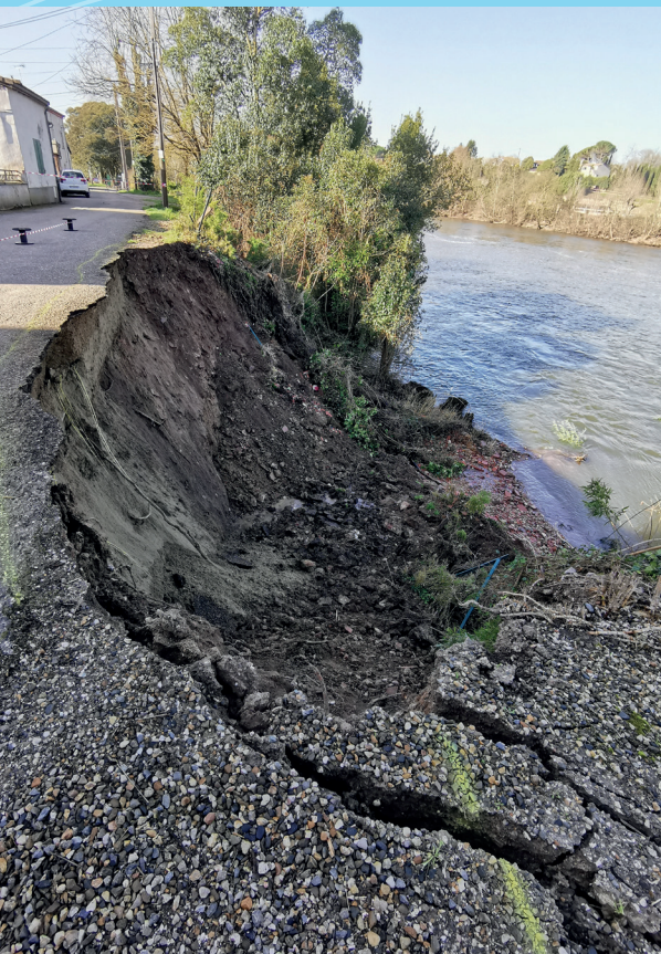
Glissements de terrain le long du Lot
