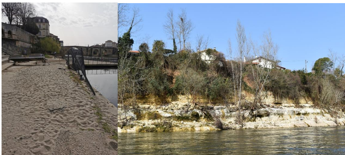
Illustration 38 : villeneuve sur Lot : dégradation d'ouvrages publics (cale de la Marine) et érosion de falaise (rive droite aval du barrage)
